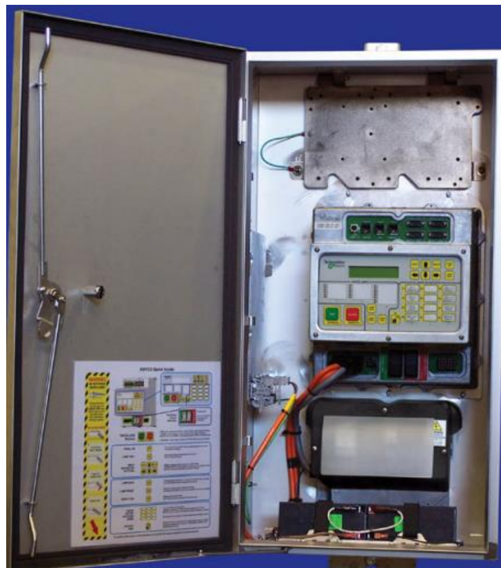
Tủ điều khiển Recloser
